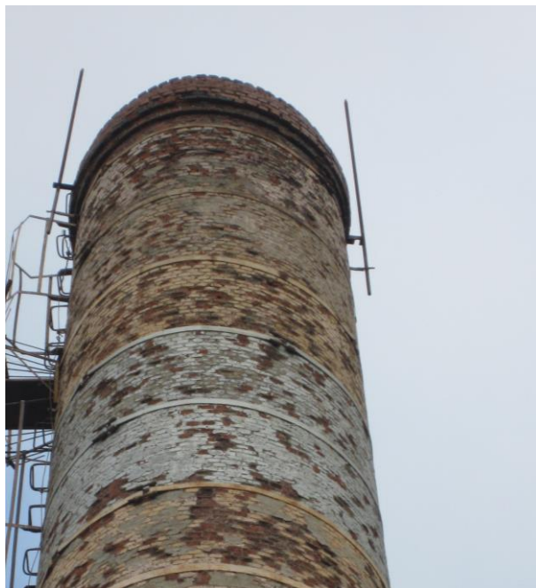
Рис.4 Выпадение кирпичей на промышленной трубе г.Алатырь, Чувашская республика
