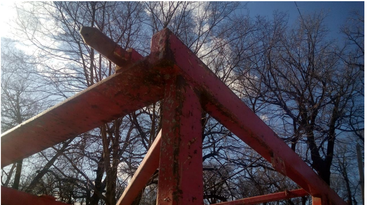
Рис.3 Коррозия конструкций башенного крана (Terex)
