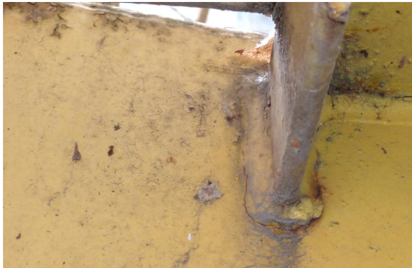
Рис.2 Трещины в металлоконструкциях башенного крана (Liebherr)
